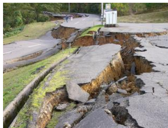
排水施設の変状
