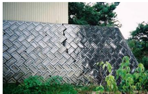
練積みのクラック
