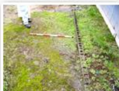
②被害状況確認(宅盤)
