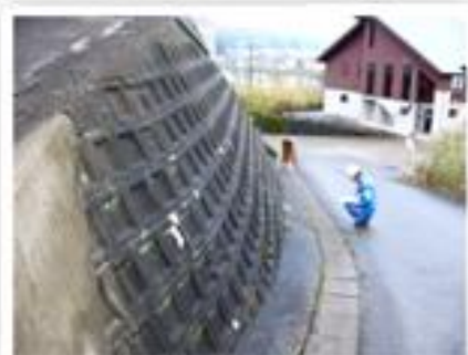
①被害状況確認(擁壁)
