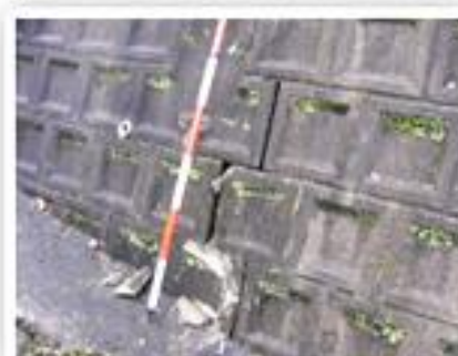
③被害状況の詳細調査
