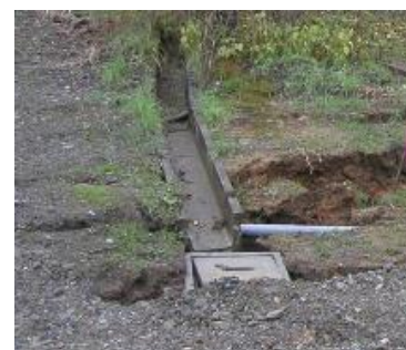
排水施設の変状
