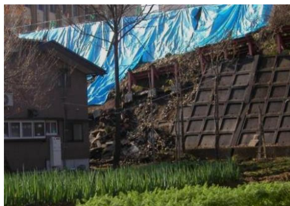
のり面保護工の変状
