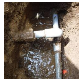
擁壁背面の水道管の破裂
