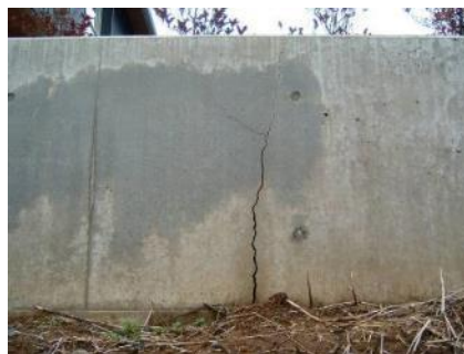
コンクリート擁壁のクラック
