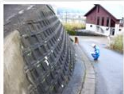
①被害状況確認(擁壁)
