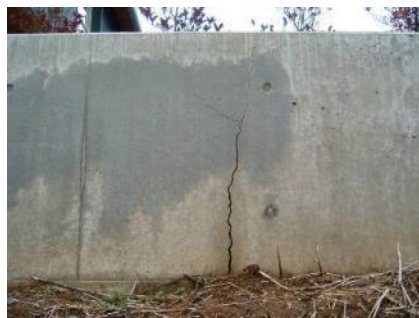
コンクリート擁壁のクラック
