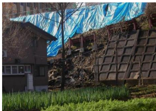
のり面保護工の変状
