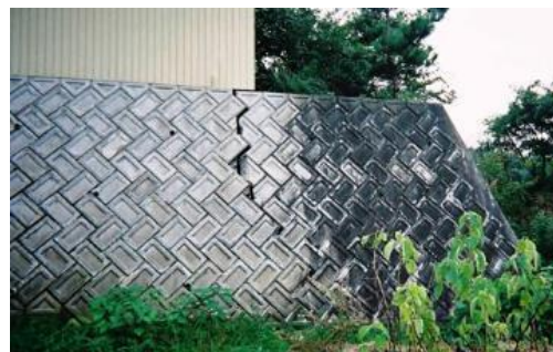
練積みのクラック
