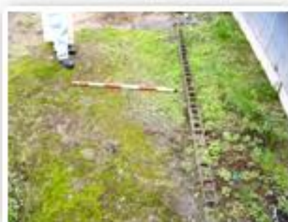
②被害状況確認(宅盤)
