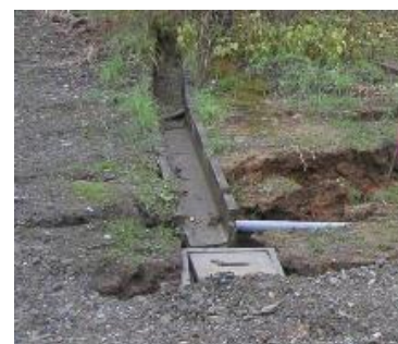
排水施設の変状
