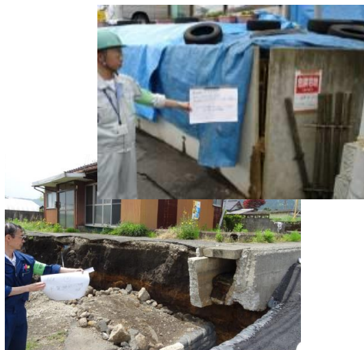
被災宅地危険度判定活動
