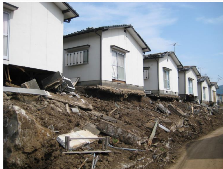
H28熊本地震の被害
