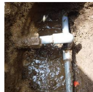
擁壁背面の水道管の破裂
