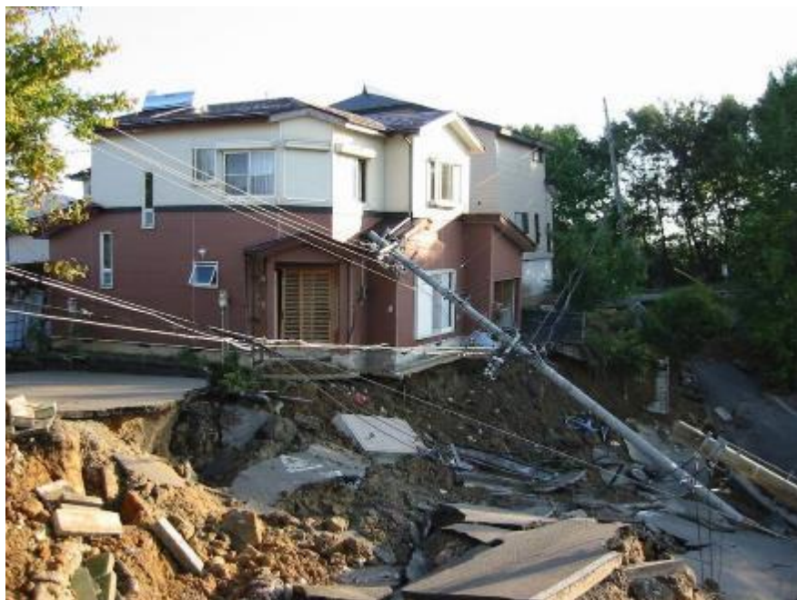
H16新潟県中越地震の被害
