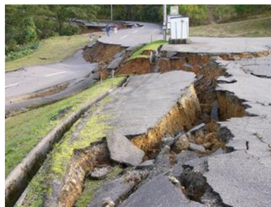
排水施設の変状
