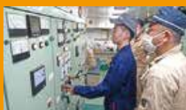
発電機並列運転操作
