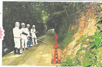
6月の大雨で土砂が流出した遊歩道沿いの斜面を確認する市職員ら。25日午後、宇和島市丸の内。
