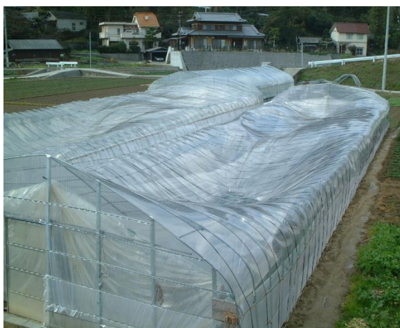
上からの強風による屋根の変形
