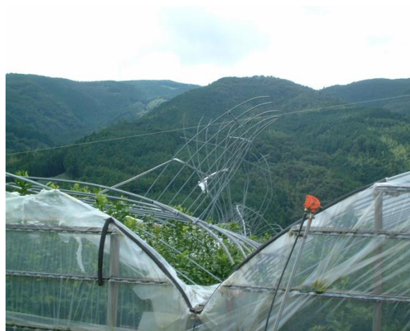
風の吹き込みによる アーチパイプの跳ね上がり
