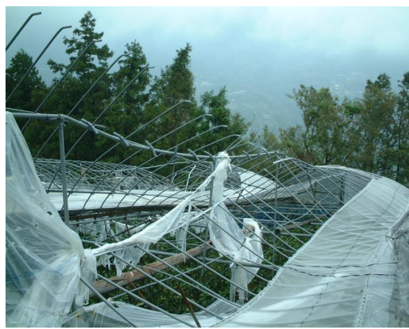
跳ね上がりと押しつぶれによる被害
