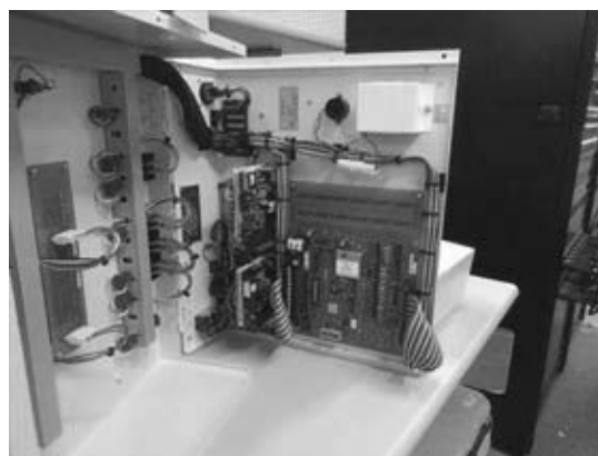
時計修繕_45 分計操作卓基板 交換済み
