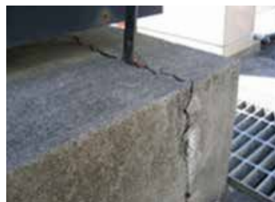
看板基礎のひび割れ
