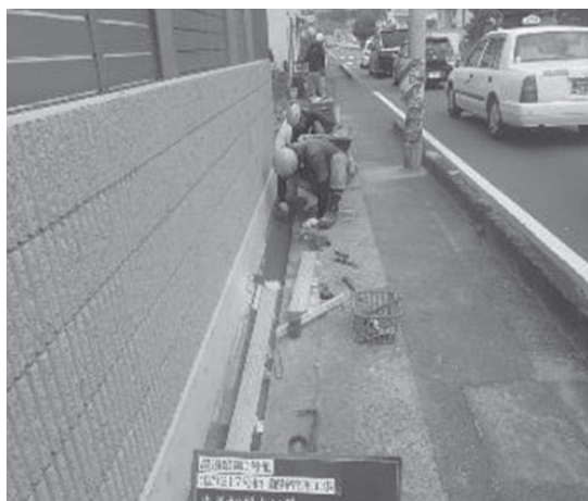
(一) 平田北条線_松山市堀江町_歩道部排水対策
