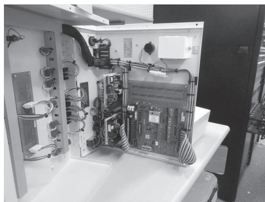
時計修繕_45 分計操作卓基板 交換済み
