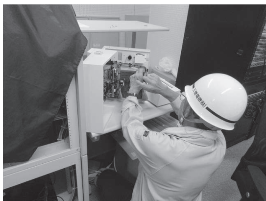
時計修繕_45 分計操作卓基板 作業状況
