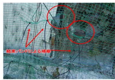
防鳥ネットの補修部分からさらに開けられた穴（赤丸部分）
