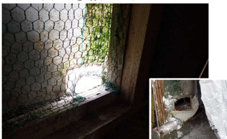
鶏舎の金網の破損部位。 小動物が入り出した痕跡あり
