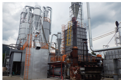
木質バイオマス発電所
