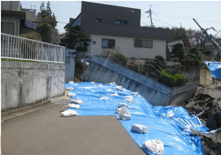
(c)腹付け盛土の崩壊の事例
