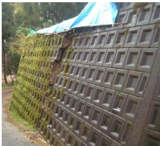
(a) 水抜穴が無い前傾した擁壁
