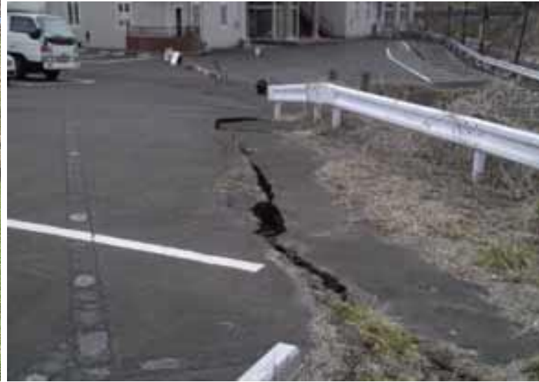
(b)のり肩の亀裂の事例
