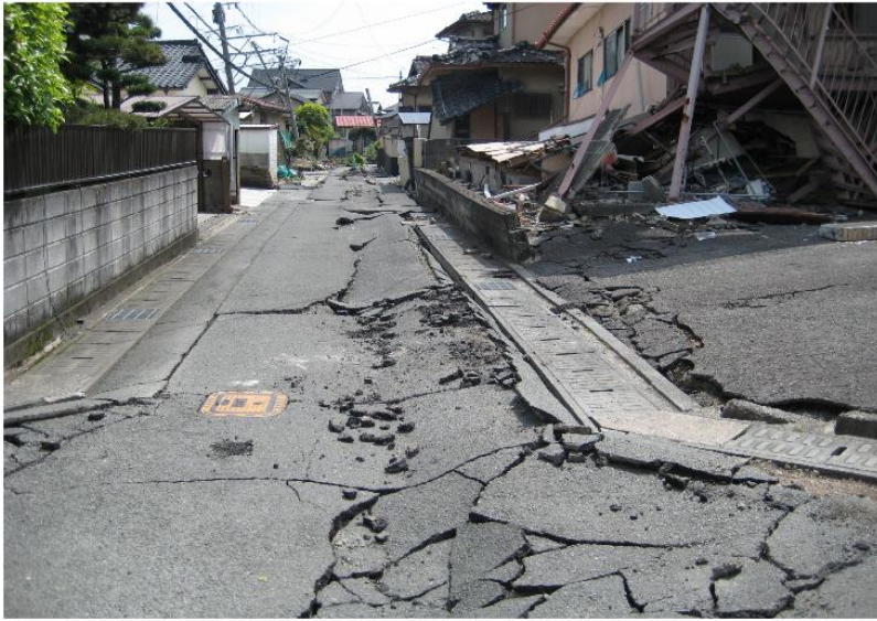
(a)道路の段差・隆起
