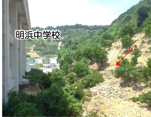
砂防関係((急)下ノ谷地区 西予市明浜町俵津) 被災時(復旧前)
