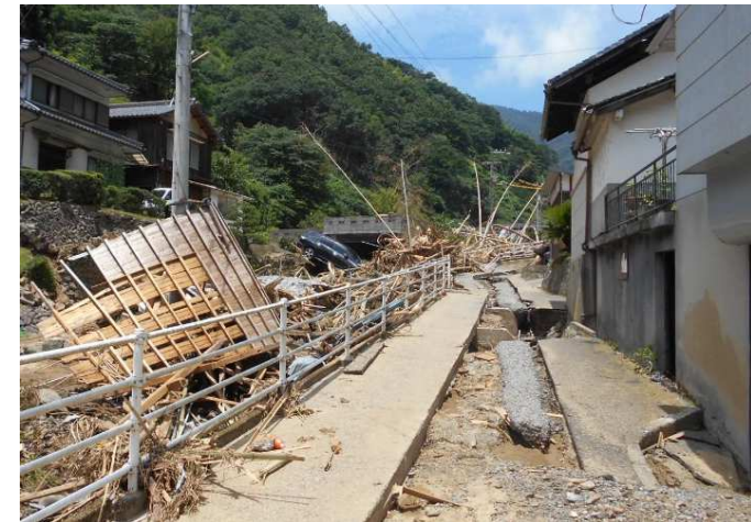
河川関係(二級河川 立間川水系 被災時(復旧前)
