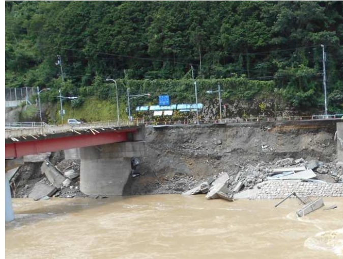
道路関係(国道197号 鹿野川橋) 被災時(復旧前)
