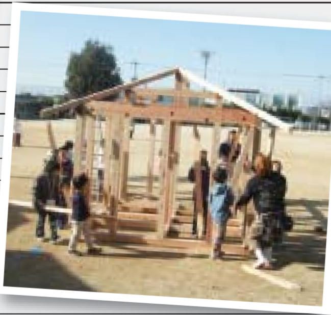
▲「きっずニア石井2010」で大工さんと一緒に小屋を建てている様子。
