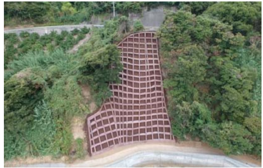
県営治山工事で松山市の北浦北地区に「吹付法砕工」を施工しました。
